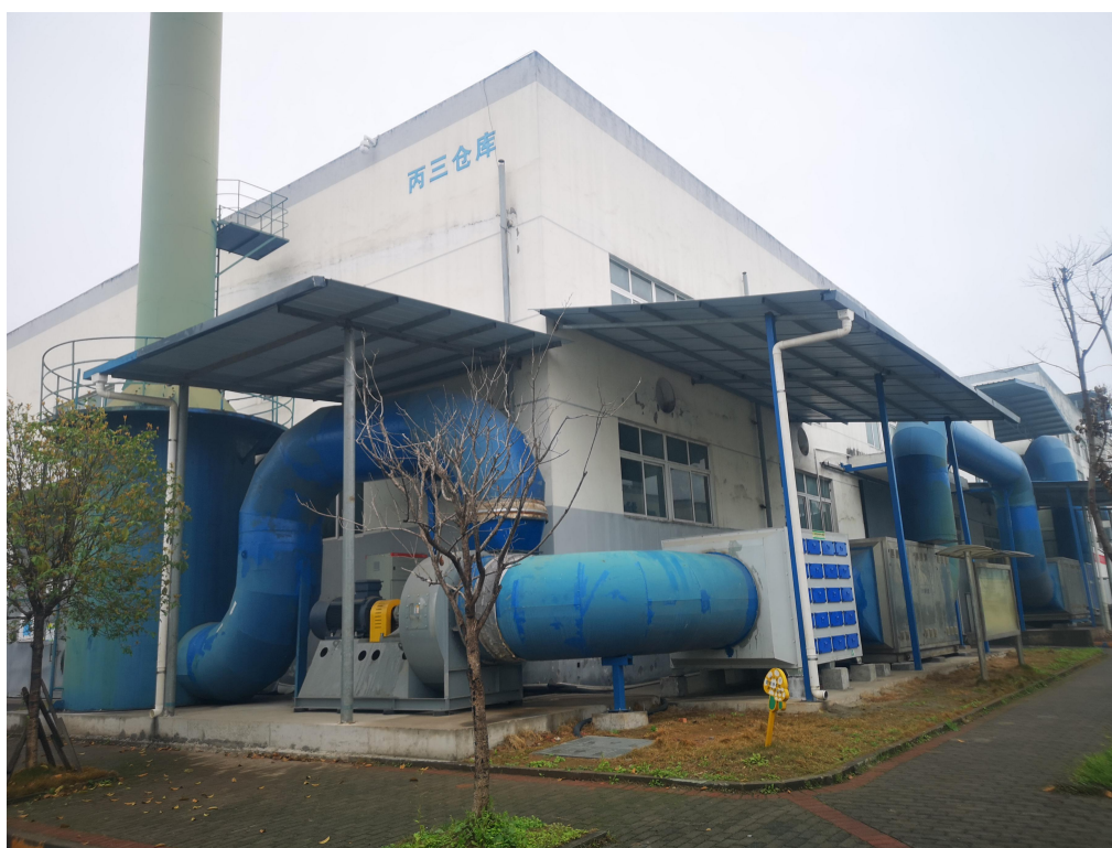
丙三仓库废气治理设施
