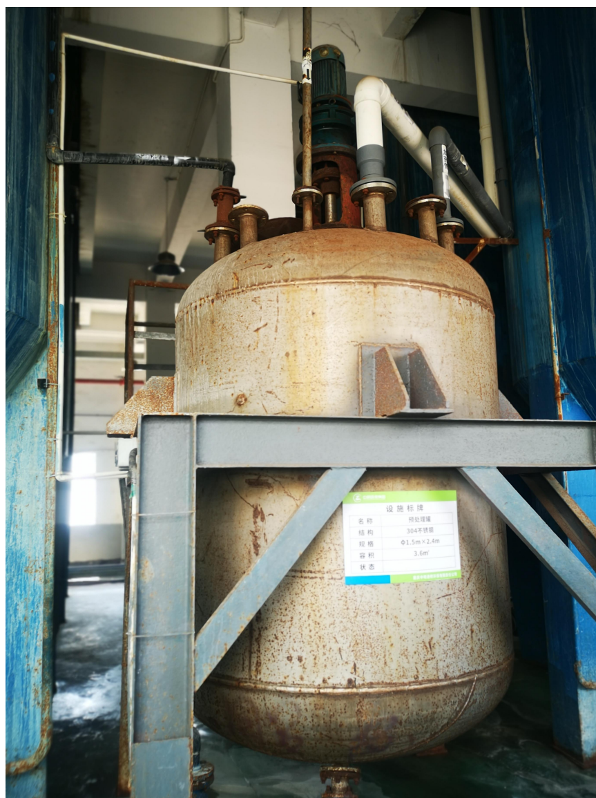
新建预处理反应罐
