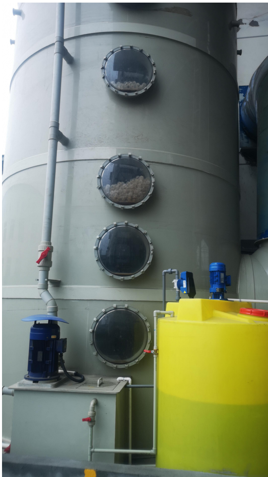
碱液喷淋洗涤塔
