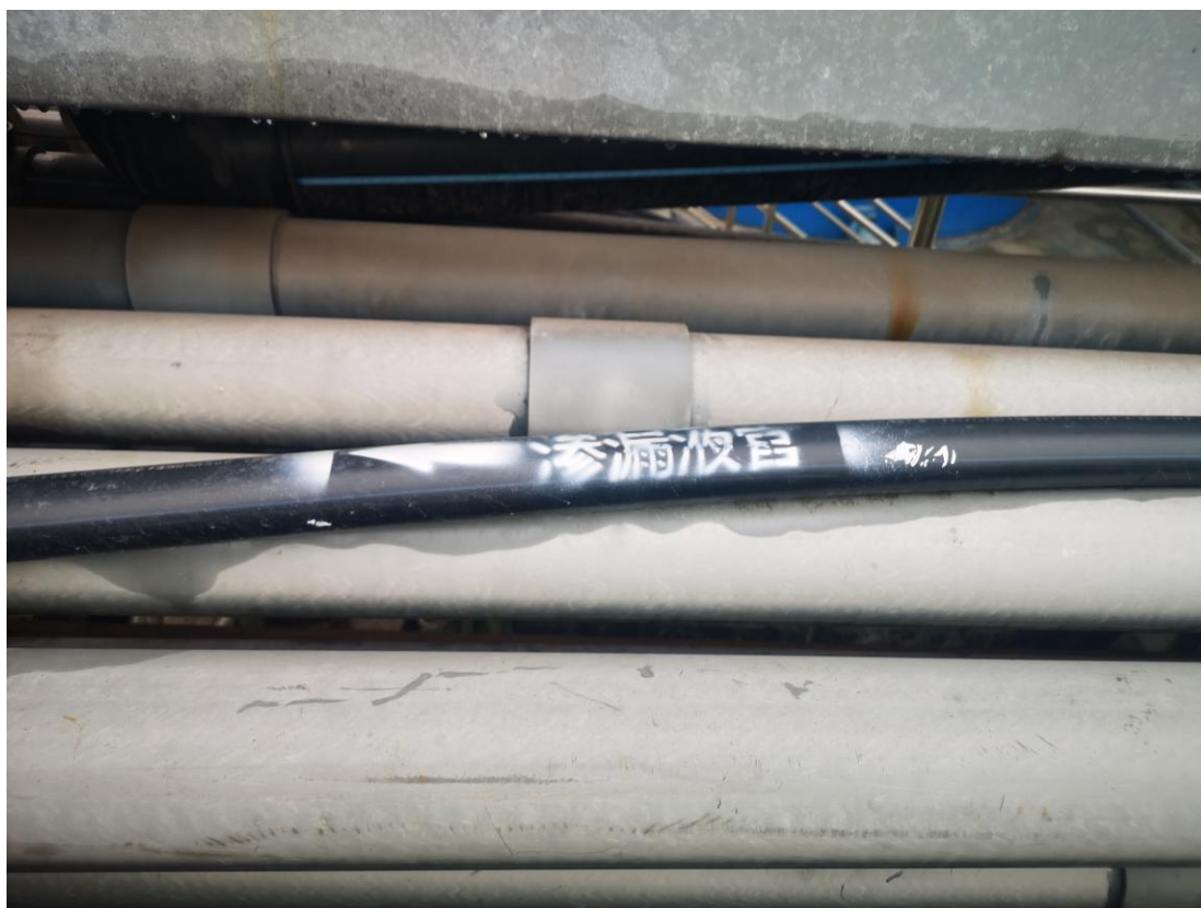
刚性填埋场渗滤液收集管
