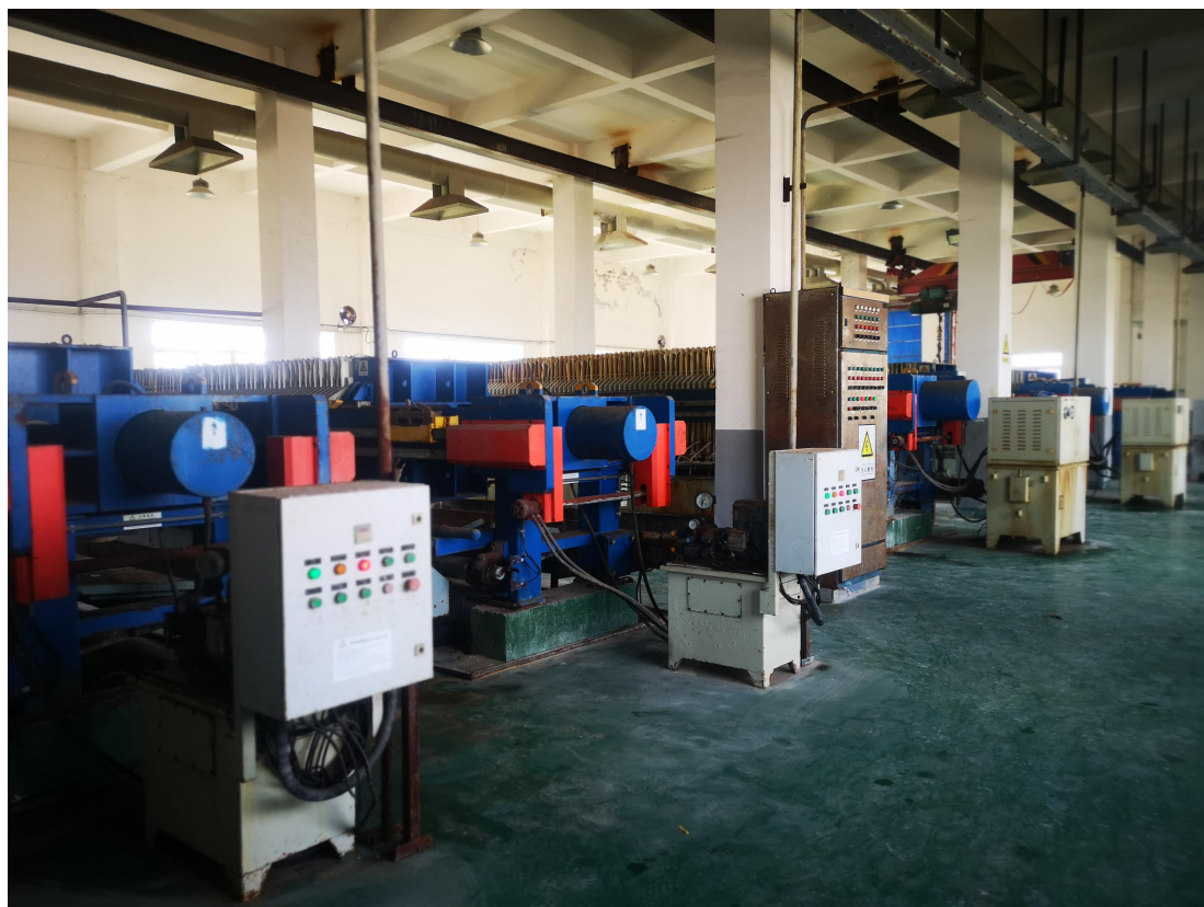
物化车间板框压滤机
