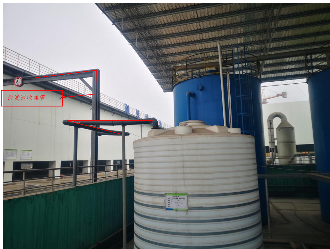
渗滤液收集管
