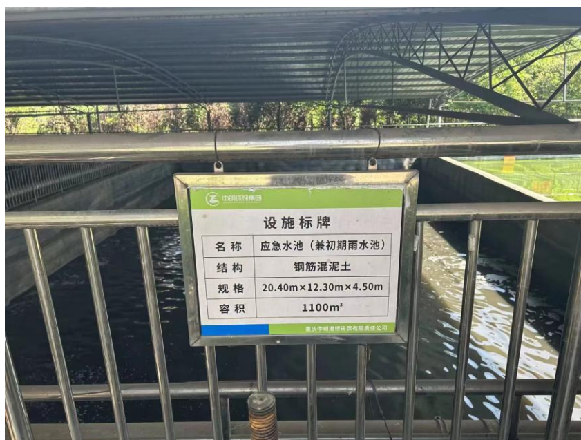
厂区事故池（有效容积 1000m 3 ）
