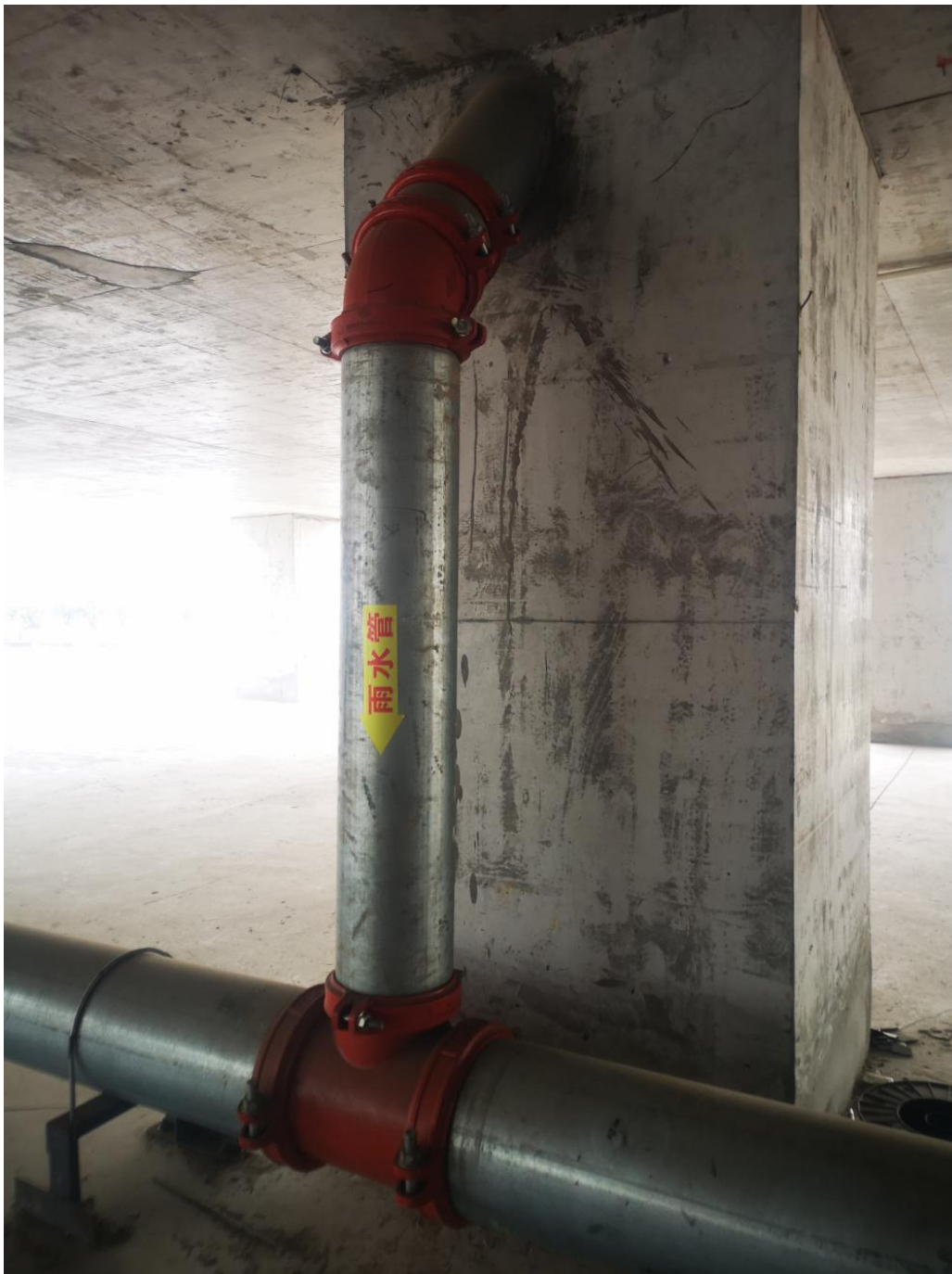
刚性填埋场雨水管
