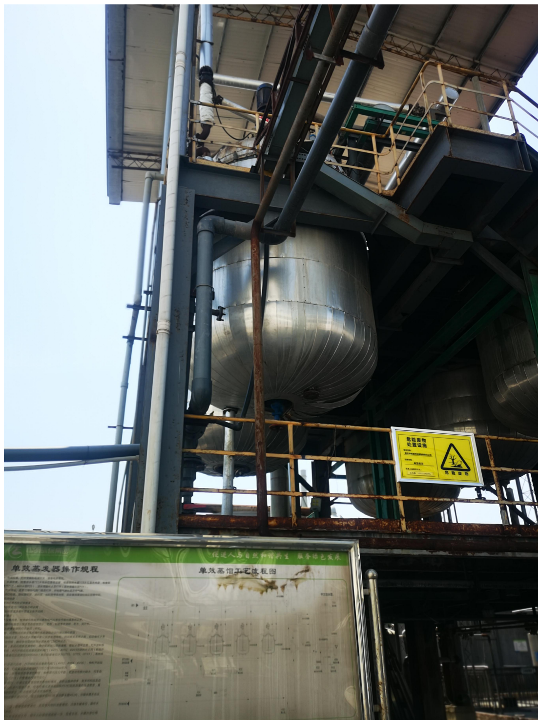
“100t/d 回转窑废物处置项目”单效蒸馏设施
