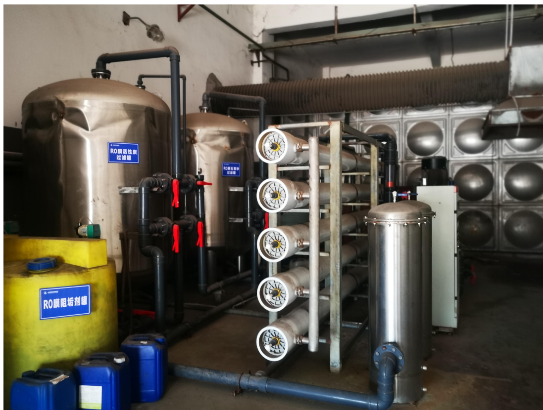
“100t/d 回转窑废物处置项目”膜过滤设施
