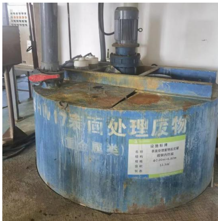
重金属废水处理系统（部分）
